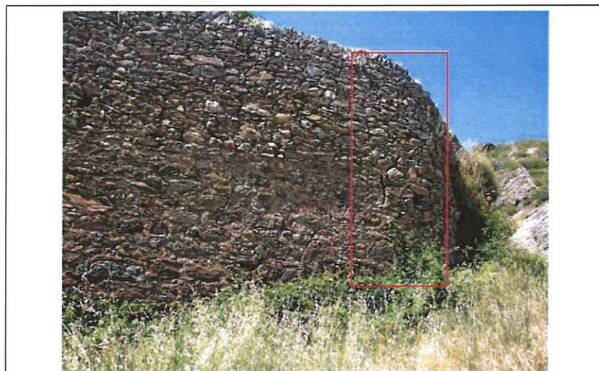
Figura 14 – Fissuração no encontro E1
