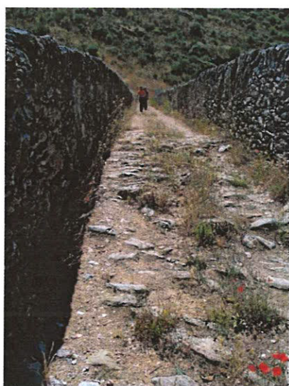
Figura 4 – Pavimento em terra
