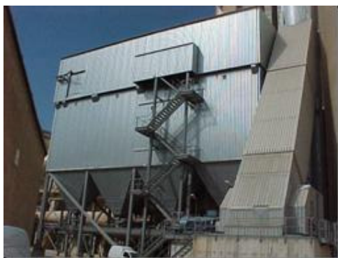
Figura 4.2 - Filtro de Mangas dos fornos 8 e 9
