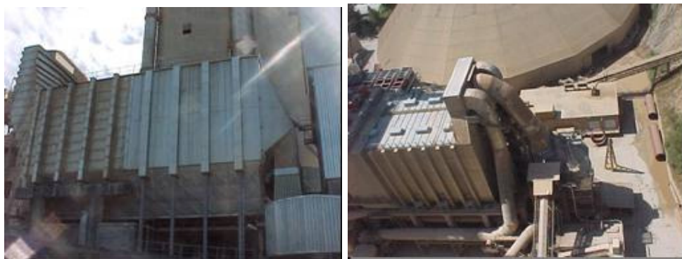
Figura 4.1- Electrofiltros dos fornos 8 e 9
