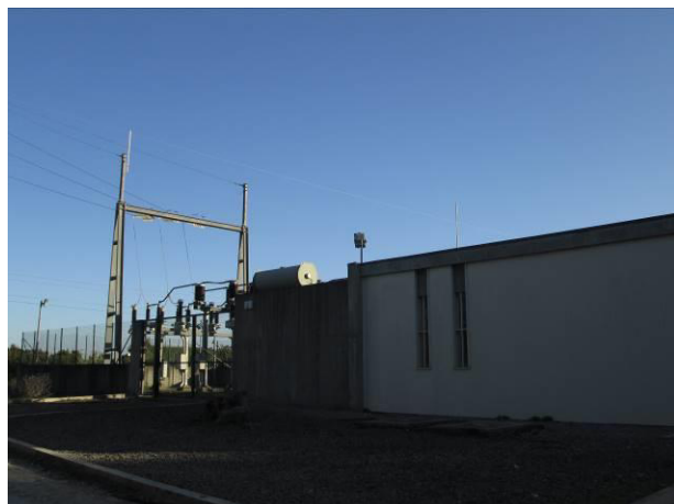
Subestação de Serra d'El Rei onde será ligado o AG14 do Sobreequipamento
