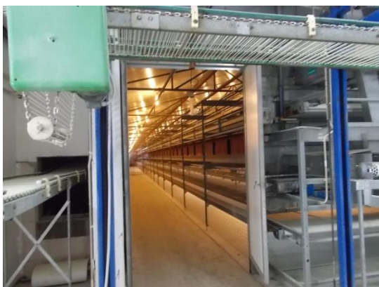
Figura 3.1 – Vista do interior do pavilhão de produção 1 (em exploração) – galinhas poedeiras no solo
