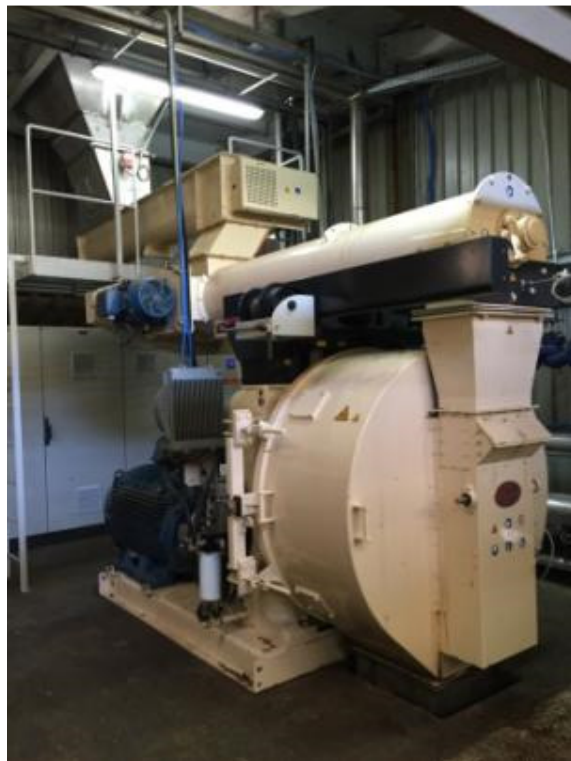
FIG.12 – Nova Granuladora instalada em 2014
