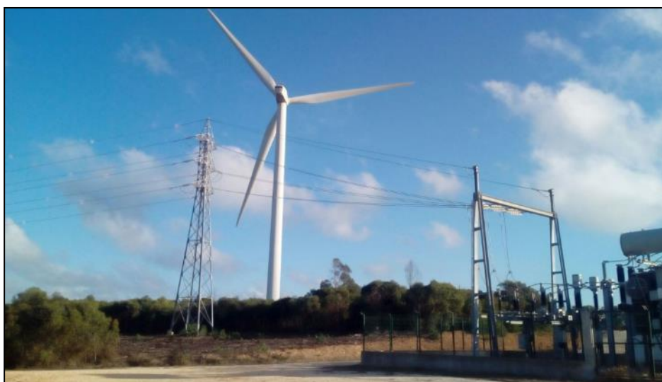
Figura 4 – Subestação existente (parque eólico do Barão de São João) e linha elétrica de interligação existente. Fonte: STRIX
