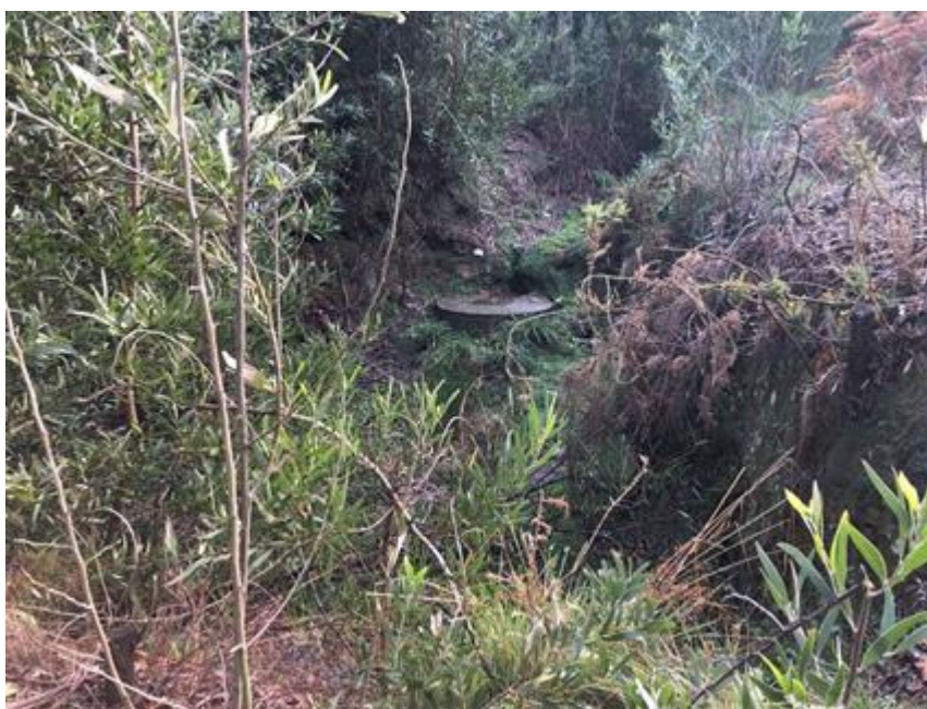
Figura 5.3 – Caixa de passagem de betão
