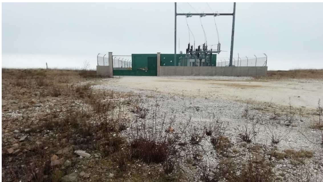
Fotografia 4.8 – Subestação do Parque Eólico de Ortiga.
