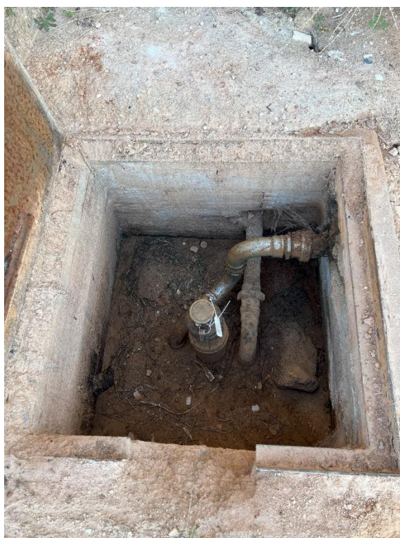
Figura 3. Identificação do depósito de gasóleo, instalado no sub-solo.
