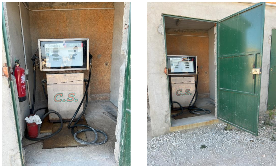
Figura 4. Identificação da bomba de abastecimento de gasóleo.
