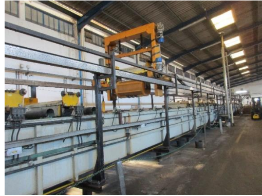
Fotografia 5 - Vista da linha de tratamento L3.
