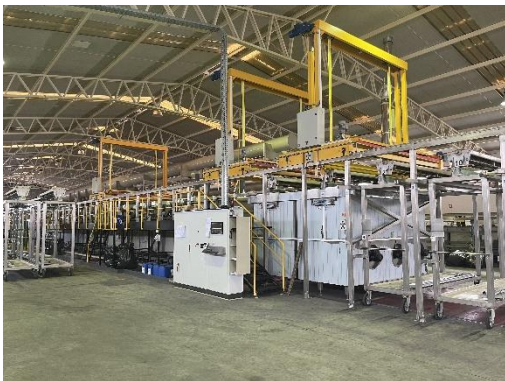
Fotografia 9 - Vista da linha de tratamento L7.
