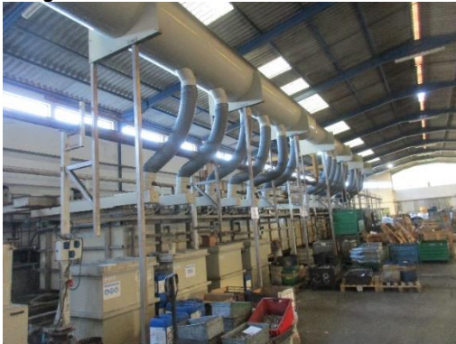
Fotografia 6 - Vista da linha de tratamento L4.
