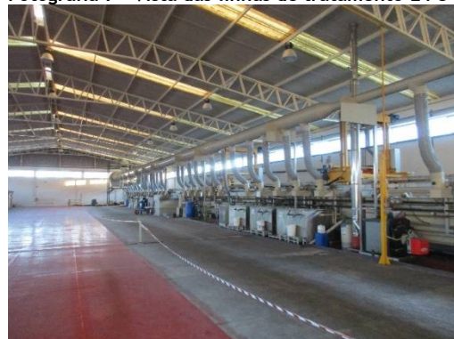
Fotografia 9 - Vista da linha de tratamento L6 antes da instalação da linha de tratamento L7.
