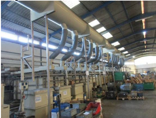
Fotografia 6 - Vista da linha de tratamento L4.
