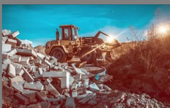
Resíduos de obras
