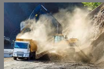
Pó gerado pelas atividades de construção
