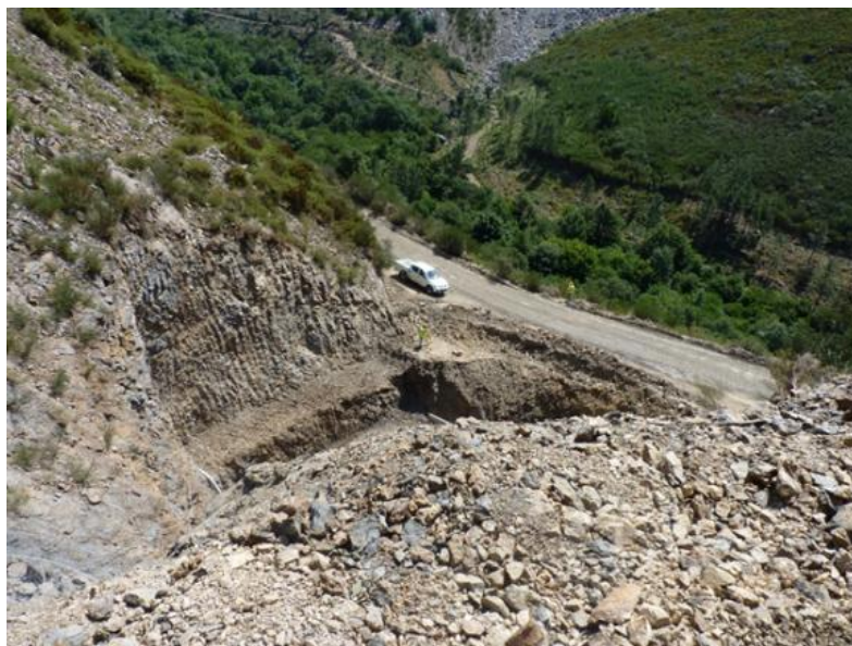
Figura 11. Pormenor do ponto EH10 a montante, realização de um muro de terra armada
