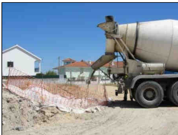
Fotografia 26 – Exemplo de uma bacia de decantação para lavagem das caleiras das auto-betoneiras
