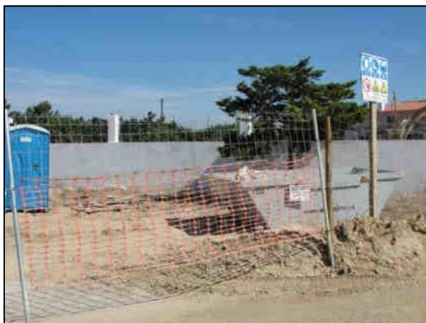
Fotografia 27 – Exemplo dos contentores colocados nas frentes de obra para recolha de resíduos
