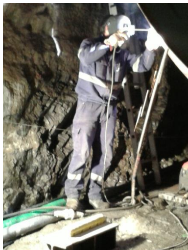
Figura 9 – Soldaduras na Blindagem da Galeria de Adução
