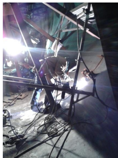
Figura 8 – Soldaduras na Blindagem da Galeria de Adução
