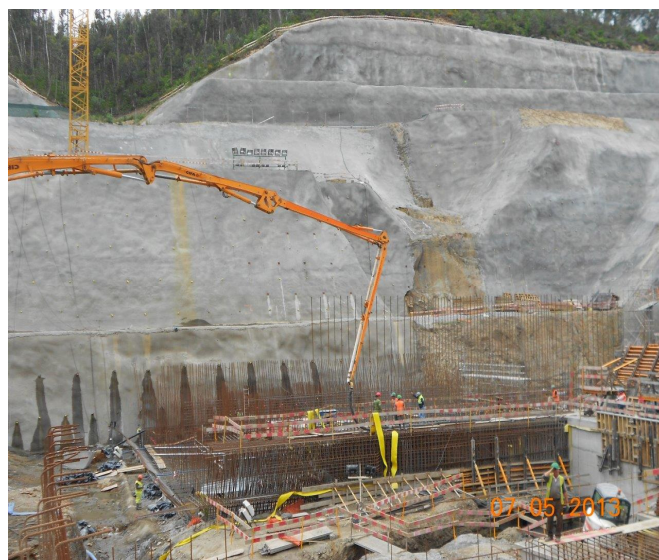
Foto 2.3.16 - Ermida - MD - Central Hidroelétrica - Betonagem da 2ª Camada na Zona da Parede Lateral e da Junta de Betonagem.
