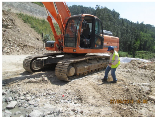
Figura 3 - O manobrador coloca terra para conter o derrame na zona com pendente para a margem do Rio Vouga.
