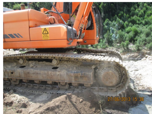
Figura 16 - Deslocação da máquina para fora da zona contaminada de modo a permitir a limpeza completa do local.
