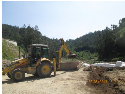
Figura 18 - Acondicionamento dos resíduos perigosos num contentor de 6m 3
