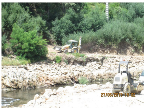
Figura 4 - A retroescavadora carrega material absorvente nas proximidades.
