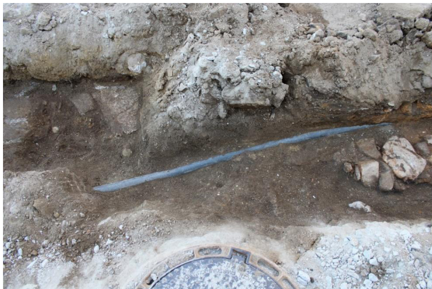
SET| Pormenor do troço afectado da calçada, vista vertical.
