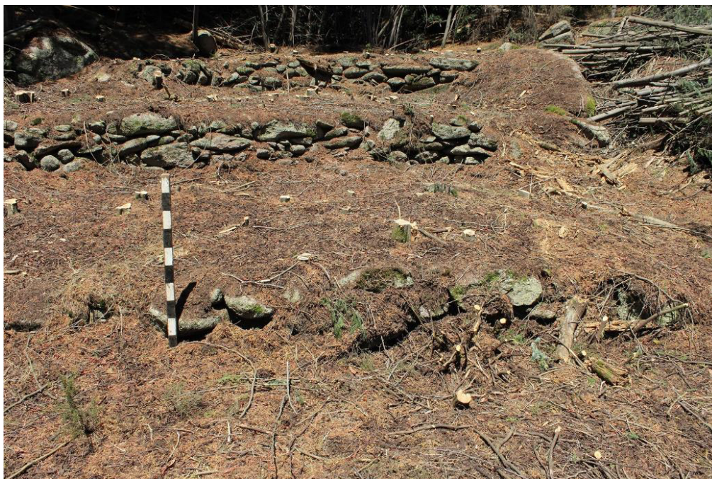
SET| Pormenor de um socalco em avançado estado de deterioração.
