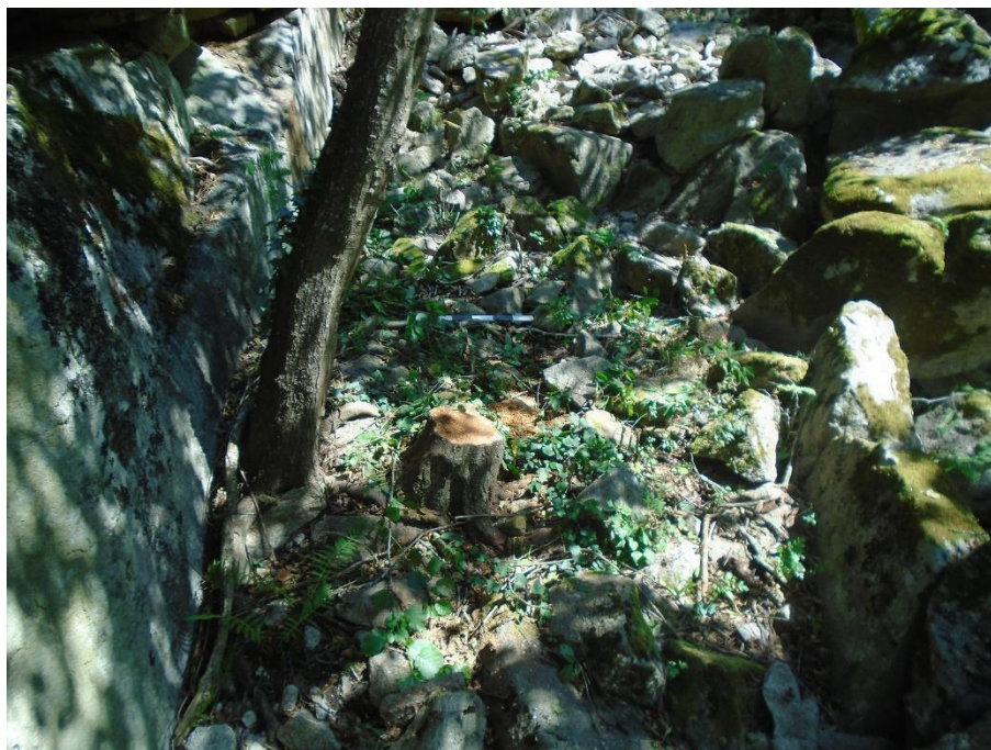
SET| Pormenor de um troço de levada afetado pelo escombro da pedreira.
