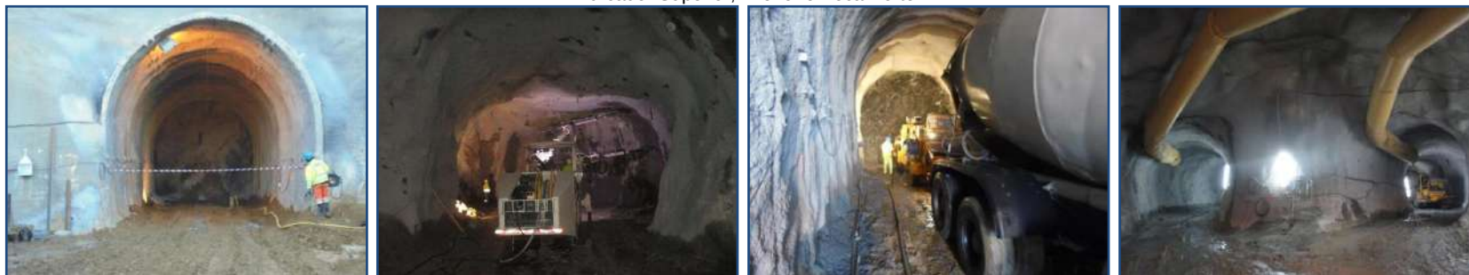
Central de Gouvães e Poço de Cabos
