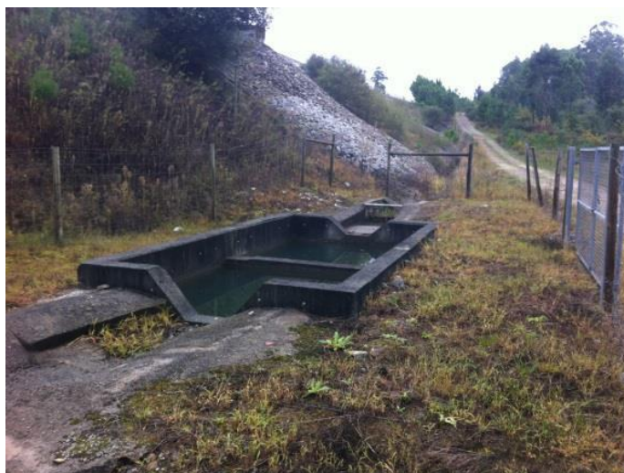
Figura 3: Sistemas de tratamento das águas de escorrência da via, localizados aos pk 1+000 e 1+500 nas margens do Rio Seixo
