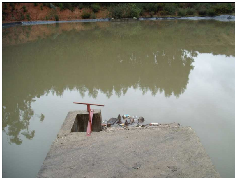
Figura 3.10 – Ponto de recolha 12 – local de saída da bacia de retenção/decantação projectada 2.
