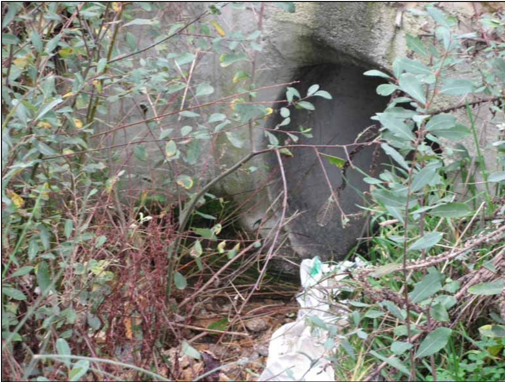
Figura AIII.50 – Ponto de amostragem 14/Passagem hidráulica 11-3 do sublanço Talhadas-Vouzela no Outono de 2006.
