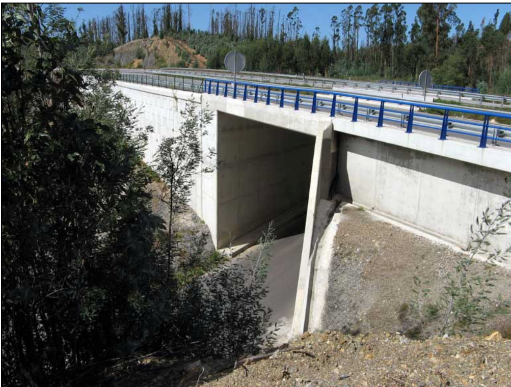
Figura AIII.6 – Ponto de amostragem 4/Passagem inferior 1 do sublanço IC2-Talhadas na Primavera de 2006.
