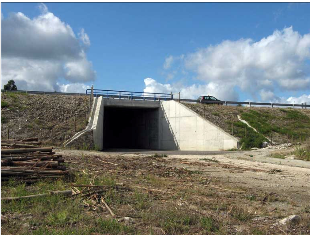
Figura AIII.23 – Ponto de amostragem 17/Passagem inferior 4 do sublanço IC2-Talhadas na Primavera de 2006.
