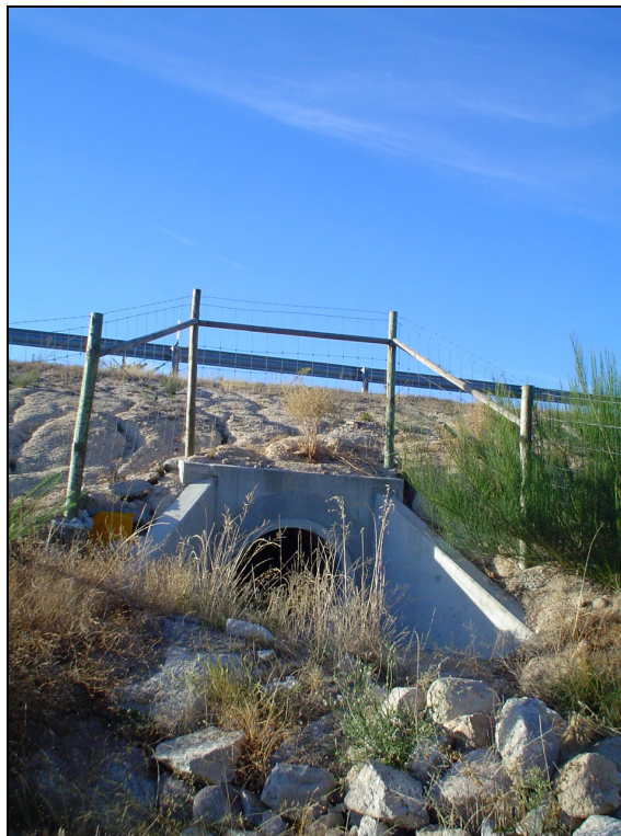
Figura AIII.84 – Ponto de amostragem 2/Passagem hidráulica 6-2 do sublanço Guarda-Vilar Formoso na Primavera de 2006.
