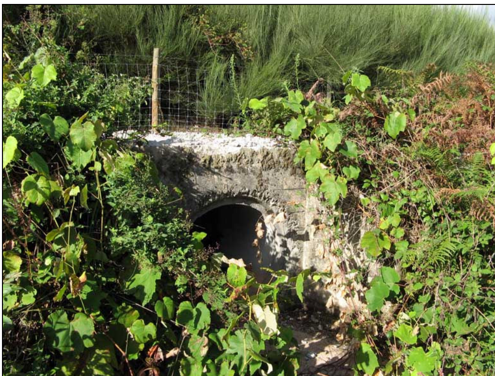
Figura AIII.37 – Ponto de amostragem 8/Passagem hidráulica 5-1 do sublanço Talhadas-Vouzela na Primavera de 2006.
