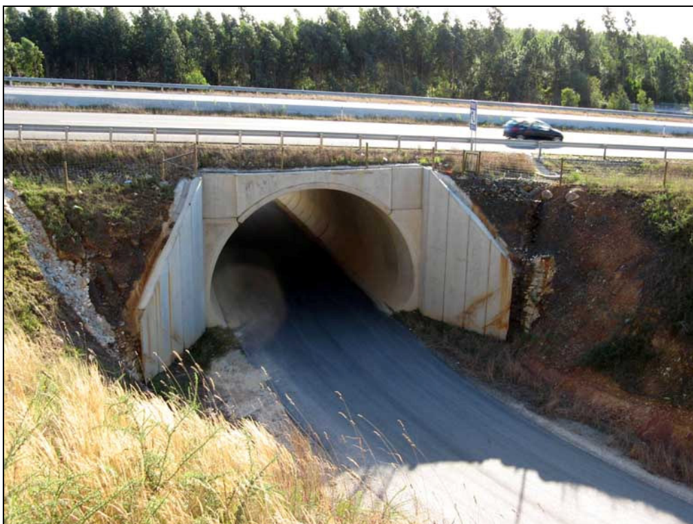
Figura AIII.17 - Ponto de amostragem 12/Passagem inferior 3 do sublanço IC2-Talhadas na Primavera de 2006.
