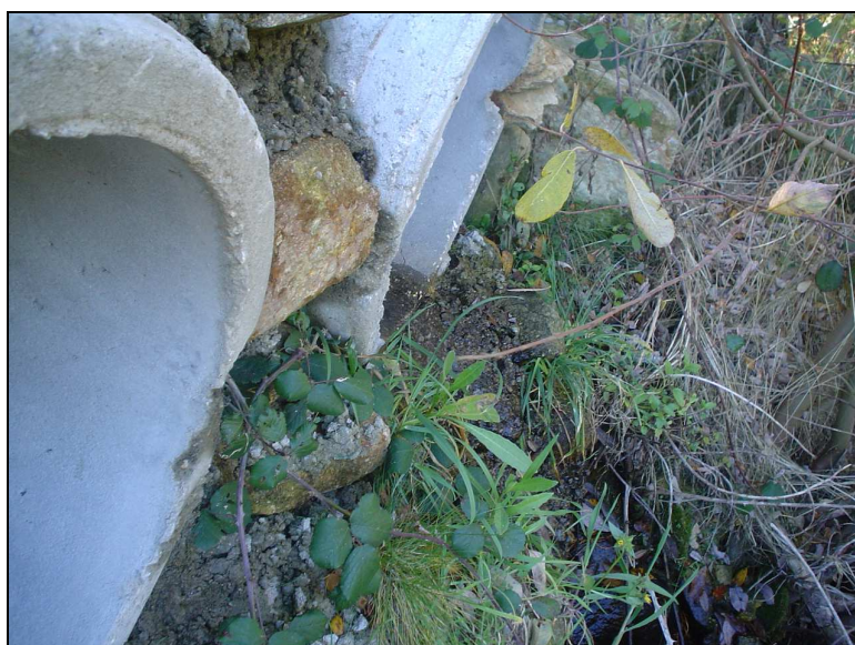
Figura 3.11 – Ponto de recolha 11 – Local de recolha de amostra das águas de descarga da plataforma antes destas serem descarregadas no meio receptor (Ribeiro da Ponte).
