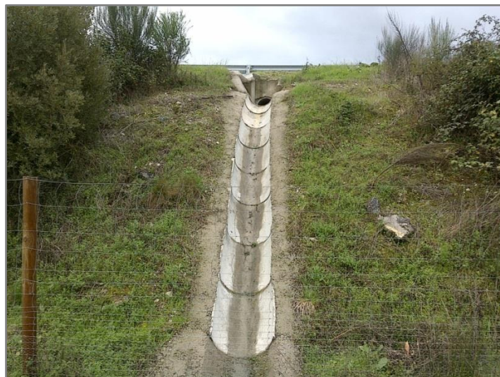
Figura 3.13 – Ponto de descarga das águas de escorrência da plataforma, localizado junto à Ribeira de Vale Pereiro, ao km 15+889.
