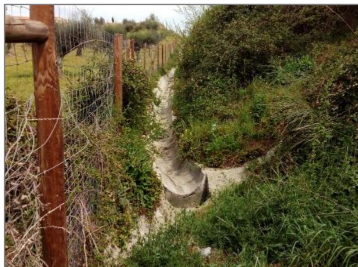
Figura 3.14 – Ponto de descarga das águas de escorrência da plataforma, localizado junto à Ribeira de Vale Pereiro, ao km 15+930.
