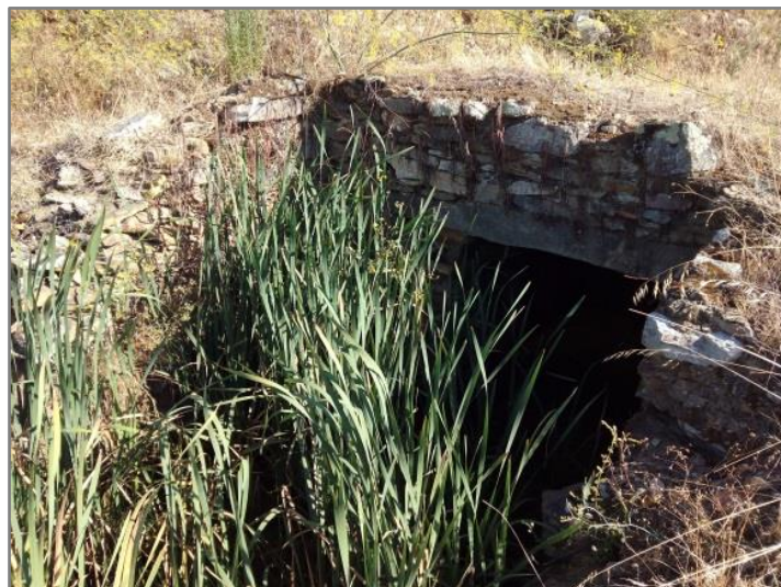
Figura 3.17 – P3, Tanque nº 25.
