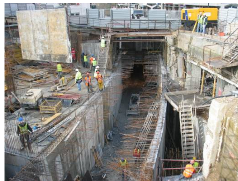
Fotografia 9: Aspecto geral dos trabalhos na zona de inserção do Ramal de Serviço na Linha Azul.
