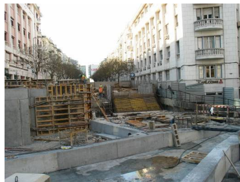
Fotografia 9: Aspecto geral dos trabalhos na zona do acesso à Av. Ressano Garcia.
