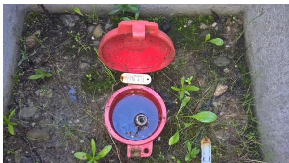
Fig. 10 - Aspecto geral do Piezómetro PH10.1 (Janeiro 2019)
