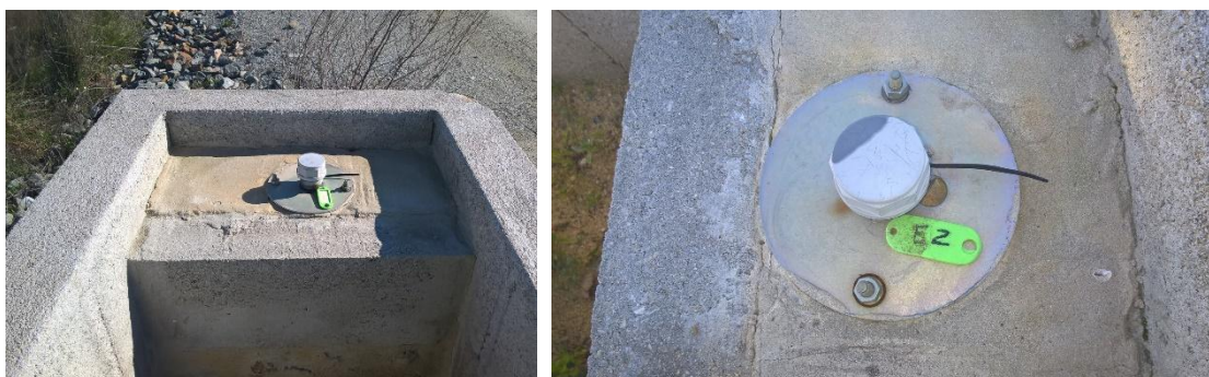
Fig.8 - Aspecto geral de um extensómetro.
