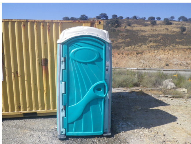
Figura 3- Casa de banho portátil
