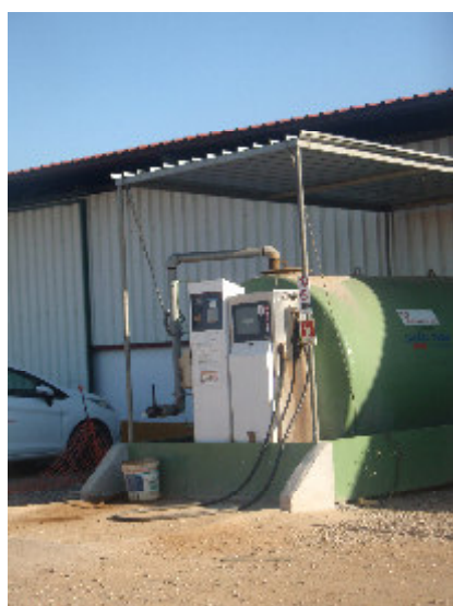
Figura 15 – Área de Apoio à Produção: Posto de Abastecimento de combustível
