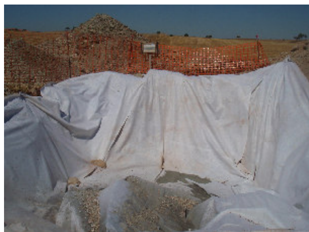
Figura 33 – Zona de Lavagem de Caleiras das Auto-Betoneiras
