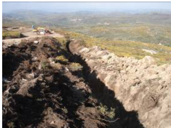
Vala de cabos (AG 19)
