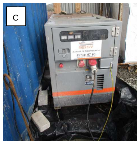
Fotografia 57 - Geradores utilizados na obra de construção do Sobreequipamento (Subparques Eólicos A – Carvalhosa, B – Picão e C – Arada – Núcleo de Manhouce).
