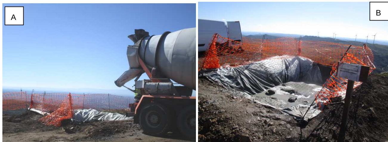
Fotografia 79 - Bacia de descarga das águas de lavagem das caleiras das autobetoneiras (A e B).
