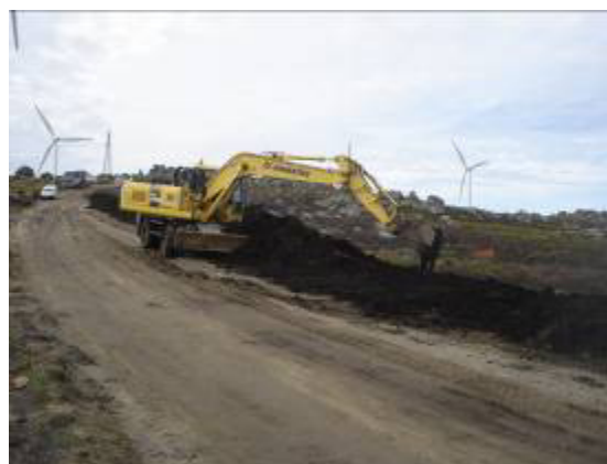
Vala de cabos (AG 18)
