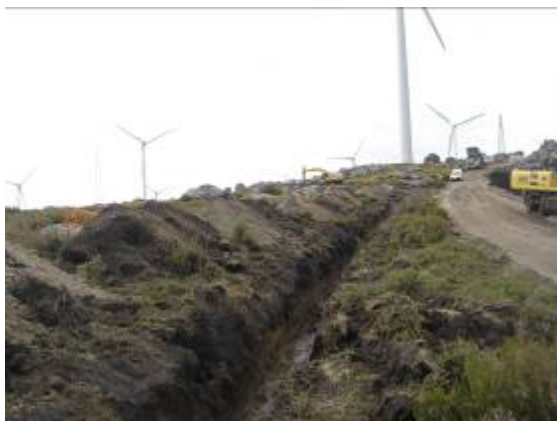
Vala de cabos (AG 18)
