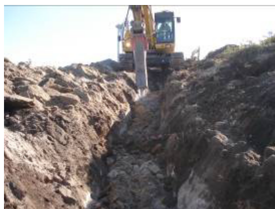
Vala de cabos (AG 19)
