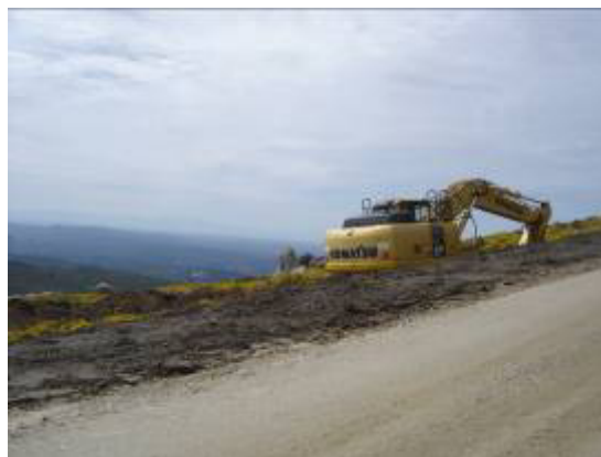
Vala de cabos (AG 19)
