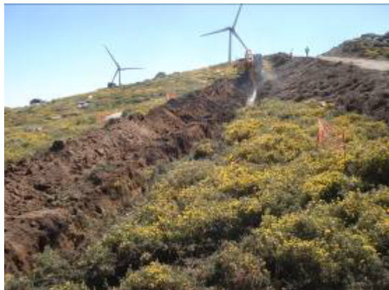
Vala de cabos (AG 19)
