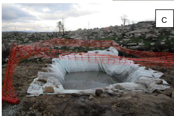
Fotografia 56 - Bacias de descarga das águas de lavagem das caleiras das autobetoneiras (Subparques Eólicos A – Carvalhosa, B – Picão e C – Arada – Núcleo de Manhouce).
