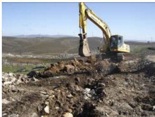
Vala de Cabos
