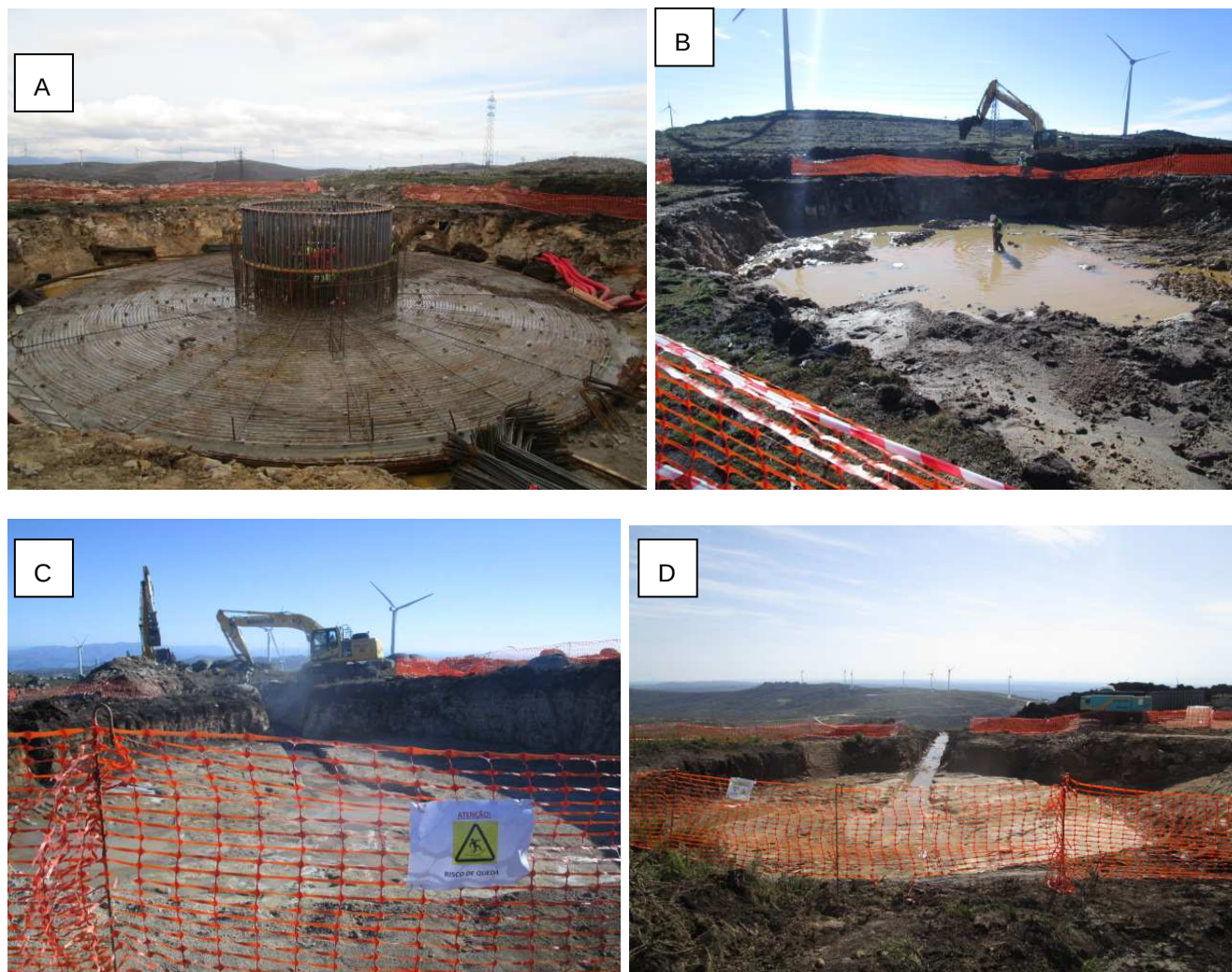
Fotografia 61 - Exemplo de balizagem das plataformas dos aerogeradores (A, B, C e D).
