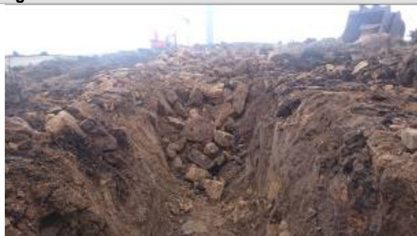
Vala de cabos
