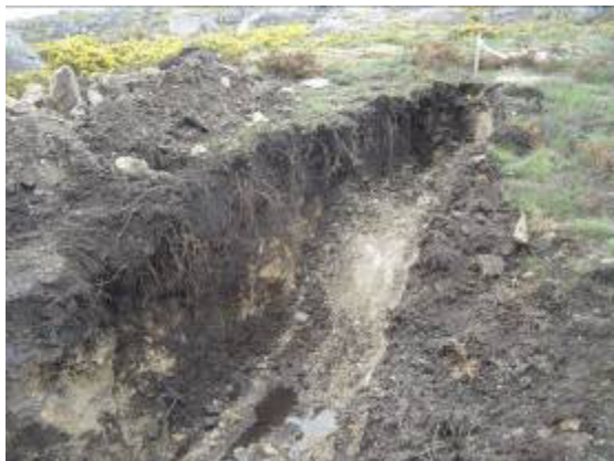
Vala de cabos (AG 19)
