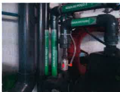
Figura 5 - Caudalímetro controlo água do furo
