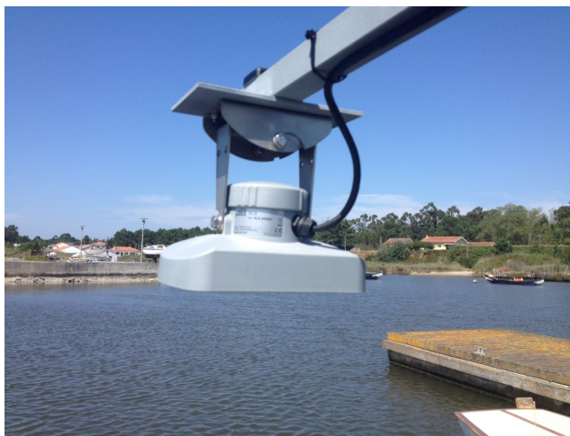
Figura 6 – Equipamento de medição de nível de maré.
