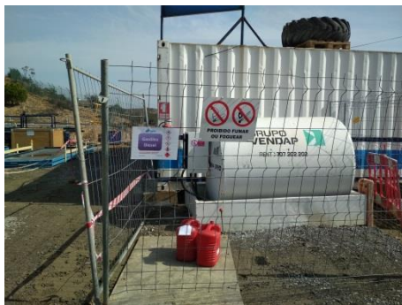
Depósito de combustível
