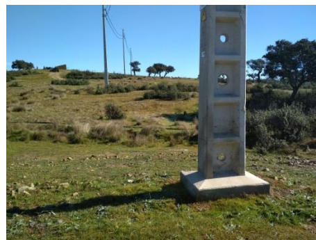
B – Bases apoios linha elétrica CPV23
