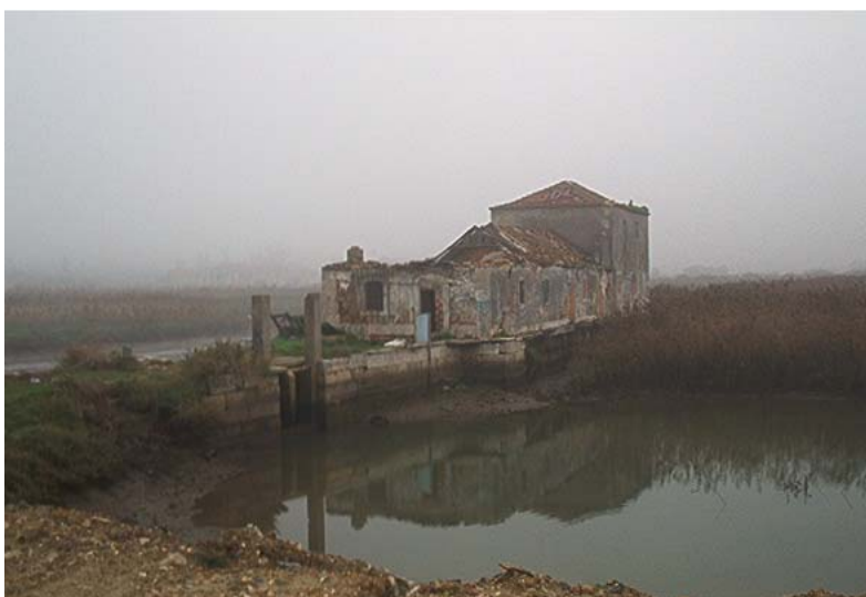
Figura IV.10.7 – Cruzeiro, Localiza-se junto ao traçado, ao km 5+150 da sol.1
