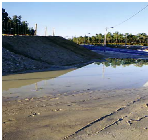
Figura VI.2.1– Acumulação de água junto a um talude de uma via recente, em virtude de deficiências no escoamento de águas pluviais
