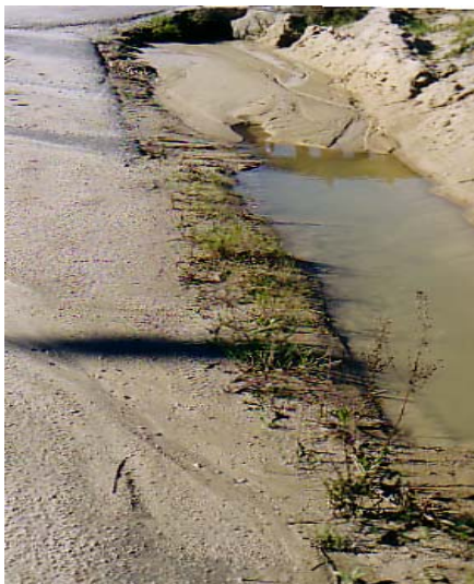
Figura VI.2.2– Acumulação de água por deficiente inclinação do escoamento
