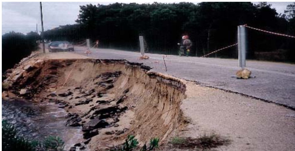
Figura 2.1 - Rombo na EN 327, ao km 52+770, antes do início da reparação (Fotografia de Janeiro de 2000)
