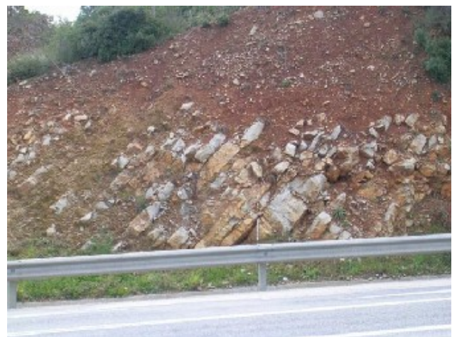
Fotografia 6 - Talude do IC2, próximo da futura ligação com IC36, onde se observam bancadas calcárias da formação do Jurássico J_{ab}^3 (Oxfordiano), sobrepostas por materiais de escorrência da encosta.
