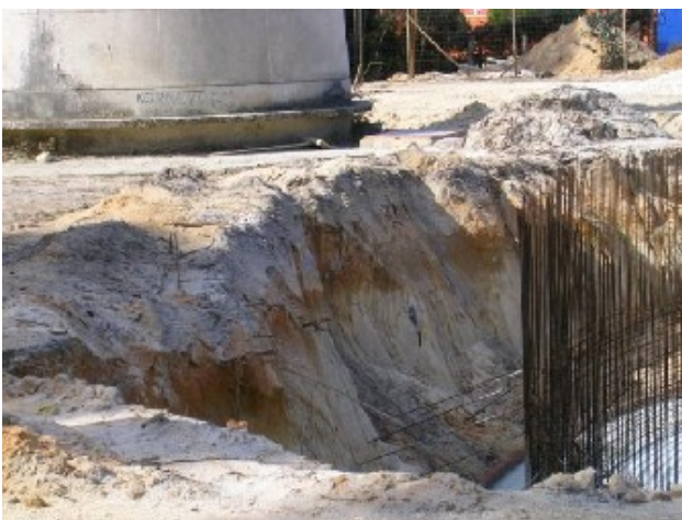
Fotografia 5 - Taludes de escavação para a construção de depósitos de água, a norte do lugar de Telheiro, onde se observa a formação arenosa do Pliocénico.
