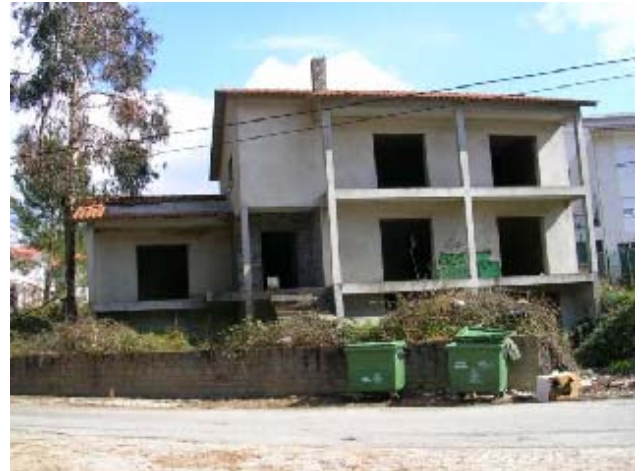
Fotografia 8 - Edificação embargada no alinhamento do ramo sul do túnel de Telheiro
