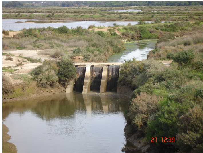
Figura 6 – Aspecto de uma comporta de controlo de escoamento à entrada dos tanques e imediatamente a montante da comporta n.º 2
