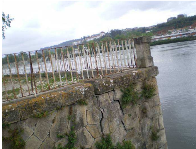
Figura 3 - Sinais de instabilidade dos muros de alvenaria de pedra
