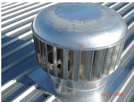
Figura 11 - Chaminé eólica de extracção natural
