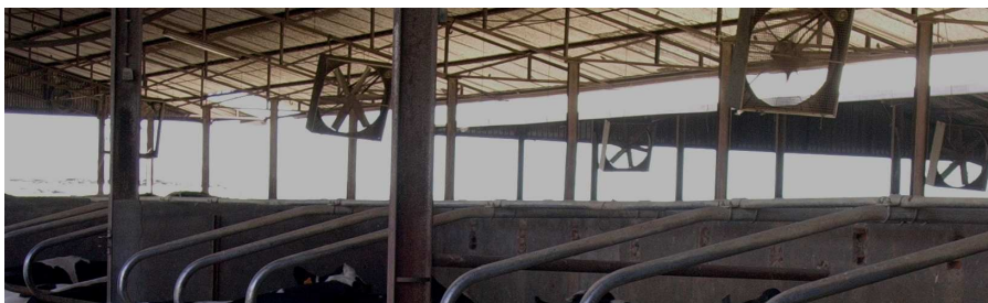
Figura 6 - Sistema de ventilação dos pavilhões.
