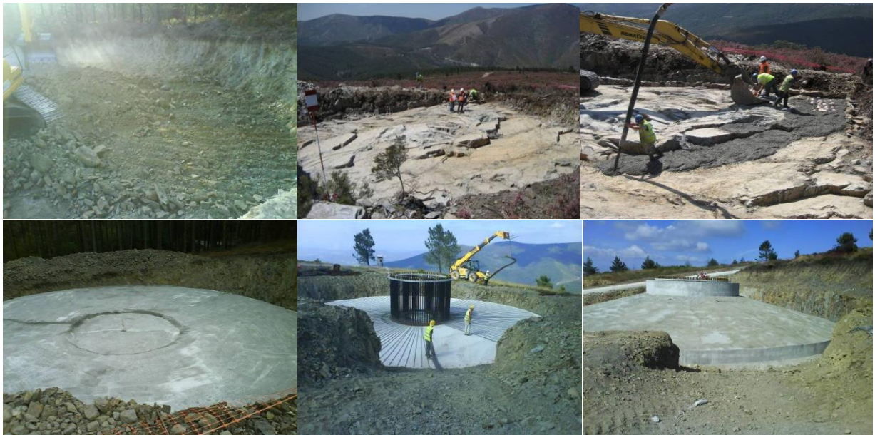
Várias etapas de betonagem na abertura dos caboucos para a execução das fundações dos aerogeradores
