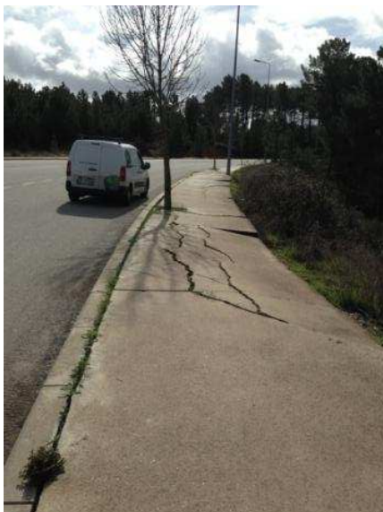
Foto 3 - Situação atual da estrada sobre o principal canal de escoamento de toda a área de intervenção (Ecofirma)
