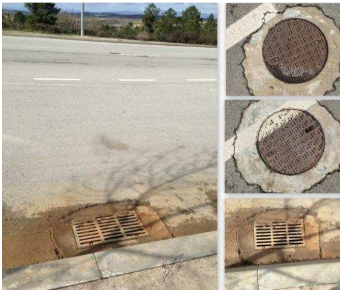
Foto 4 - Sistema de escoamento de águas pluviais e efluente existente no local (Ecofirma)
