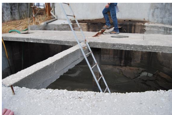
Figura 4.4 – Tanque de receção de efluentes
