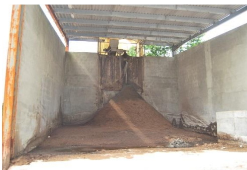
Figura 6.2 – Pavilhão de estrume com o separador de sólidos
