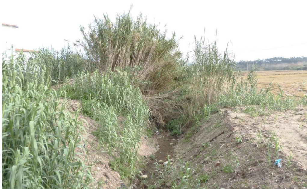
Figura 32 - Aspeto da Vala a ser desviado no início da Variante 1 invadida por cana.
