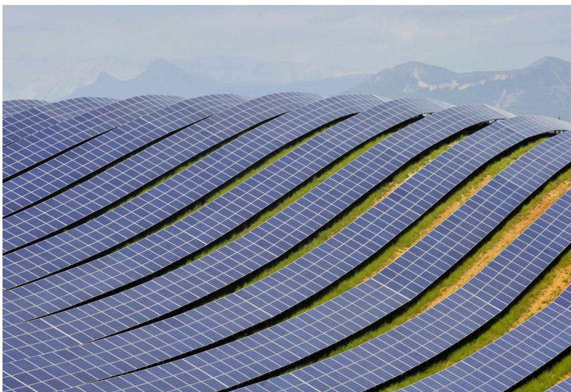
Fotografia 4.11 – Painéis fotovoltaicos que acompanham a morfologia do terreno
