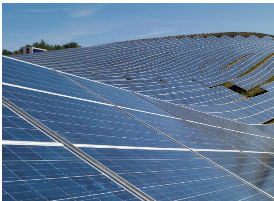
Fotografia 4.10 – Painéis fotovoltaicos que acompanham a morfologia do terreno
