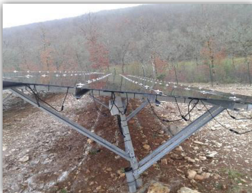
Fotografia 4.5 – Estrutura de suporte aos módulos fotovoltaicos
