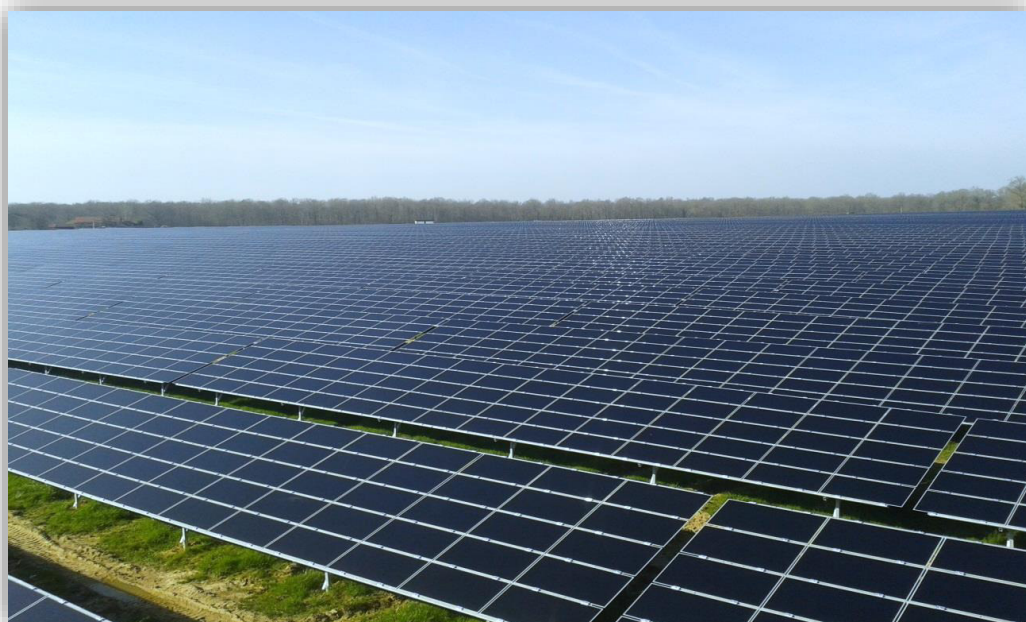
Fotografia 4.2 – Exemplo de pormenor de módulos fotovoltaicos
