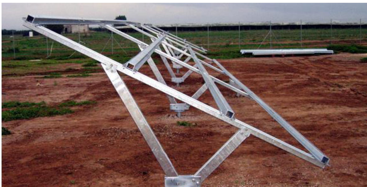
Fotografia 4.6 – Mesa de suporte de painéis fotovoltaicos (fixa ao solo com recurso a parafuso)
