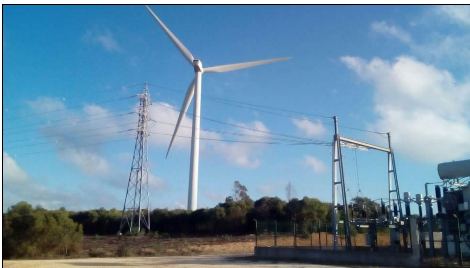
Figura 3 – Subestação existente (parque eólico do Barão de São João) e linha elétrica de interligação existente. Fonte: STRIX
