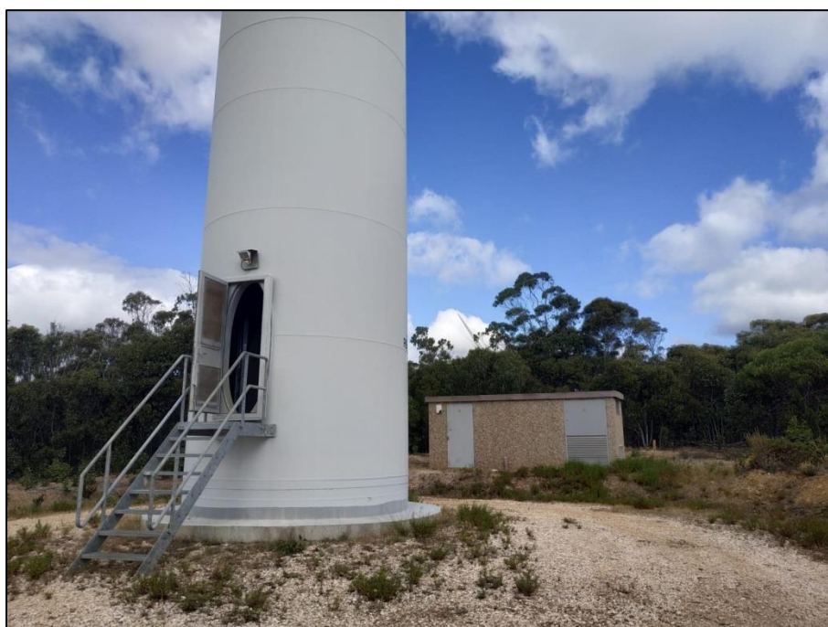
Figura 1 - Posto de transformação exterior no parque eólico do Barão de São João em exploração
