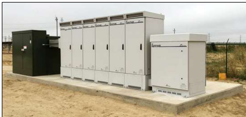
Figura 5.5 – Imagem exemplificativa de Posto de Transformação (Inversor e Transformador de Potência) sobre plataforma
